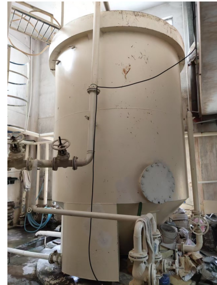
污水处理设施
